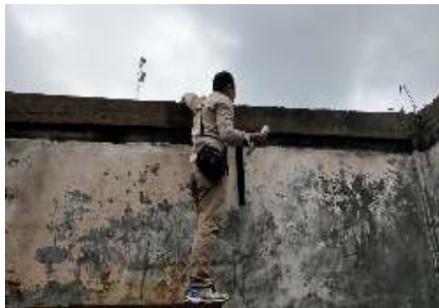
Gambar 4.18. Retak pada Balok Ring
