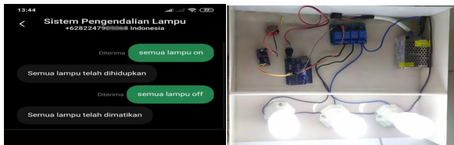
Gambar 4. 4 Uji Perintah Semua Lampu
