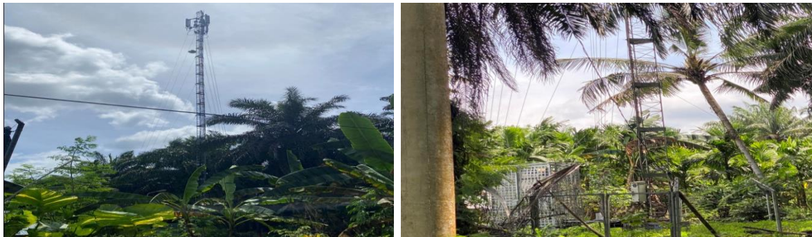
Gambar 5. tower jaringan telekomunikasi
