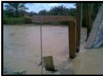
Gambar 4.6. Diagonal jembatan yang telah patah
