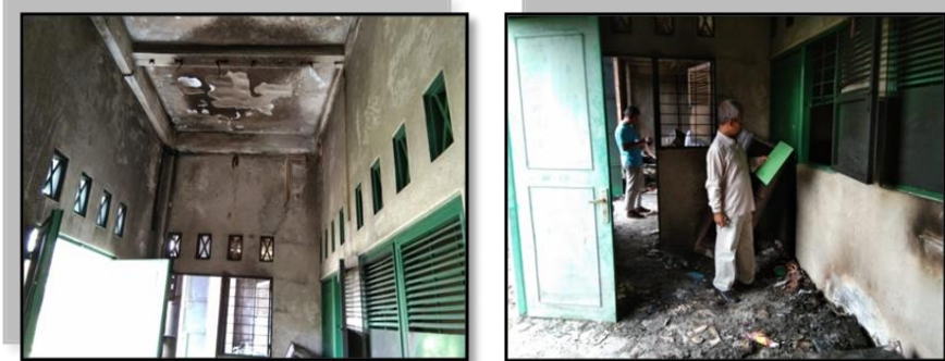
Gambar 3. Ruang 2 selasar depan yang terbakar
