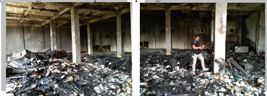
Gambar 2. Ruang arsip yang terbakar
