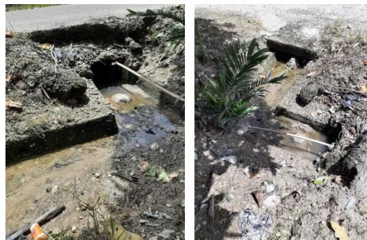
Gambar 10. Sumbatan di ruas saluran drainase
