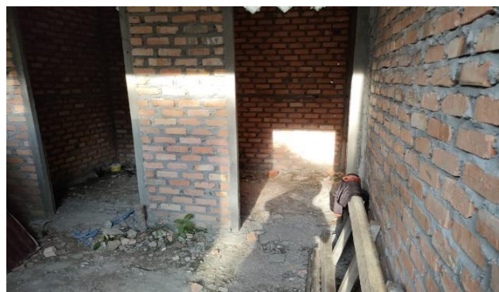
Gambar 3. Bangunan toilet yang belum selesai dilaksanakan
