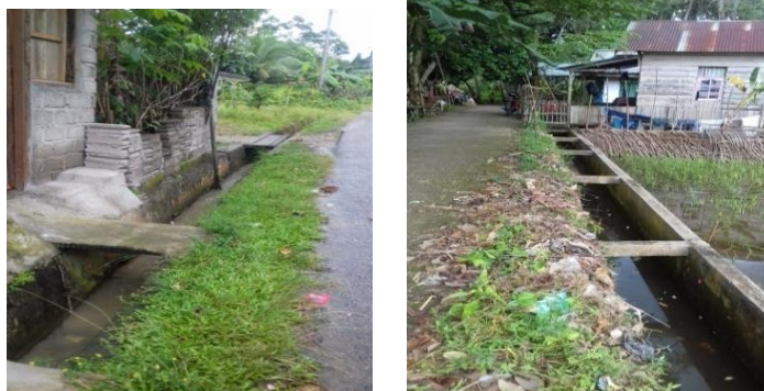
Gambar 3. Kondisi saluran air/Drainase di Desa Pulau Kijang
